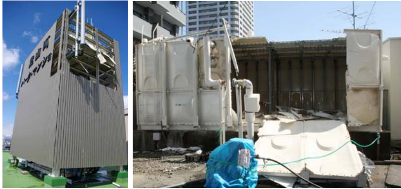
水槽の破裂（左：高置水槽、右：受水槽）
