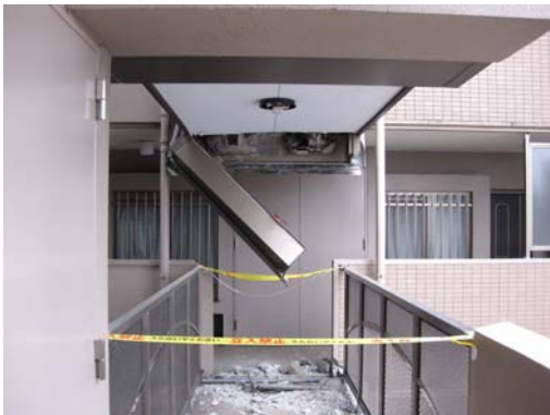
エキスパンションジョイント部の損傷
