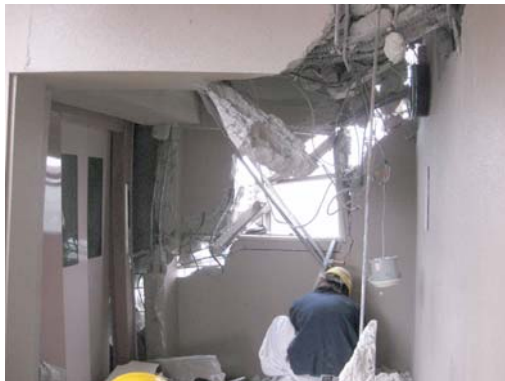
エレベータシャフトの損傷
