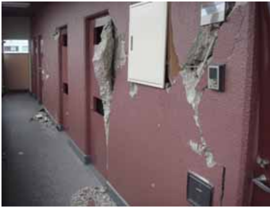
共用廊下の非耐力壁にX字型のせん断亀裂が入ったマンション。耐震補強目前の地震だった。
